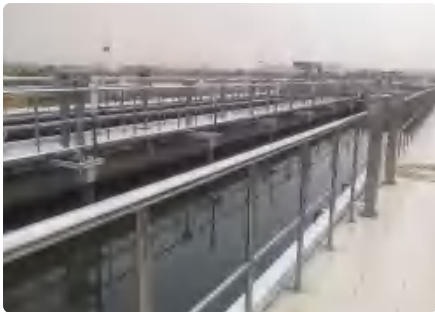
东莞某镇污水处理厂设备改造及运营
