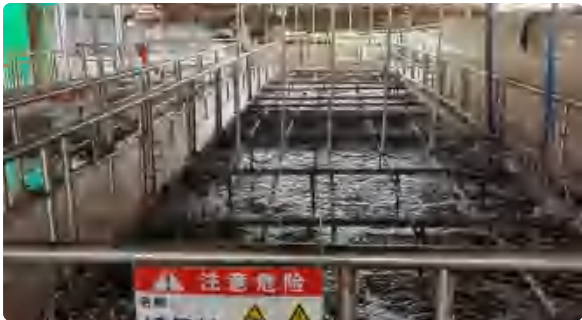
工业废水处理站现场运行实景
