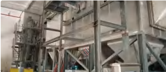
一体化污泥连续碳化系统 · 车间实景
