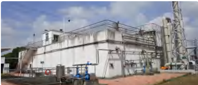
工业废水处理设施 · 现场运行实景
