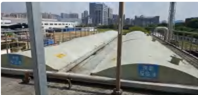
污水收集与处理设施 · 稳定达标运行
