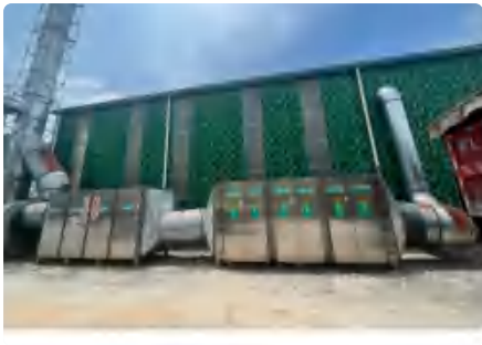
揭阳市电线电缆行业废气治理
