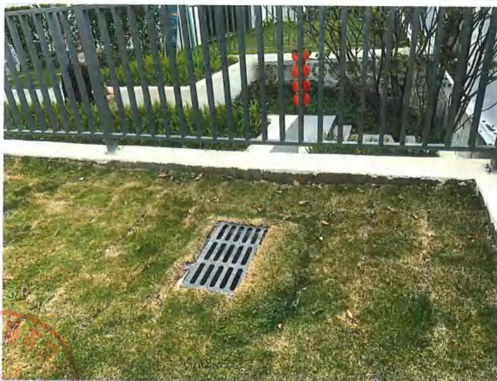
雨水管网-雨水收集口
