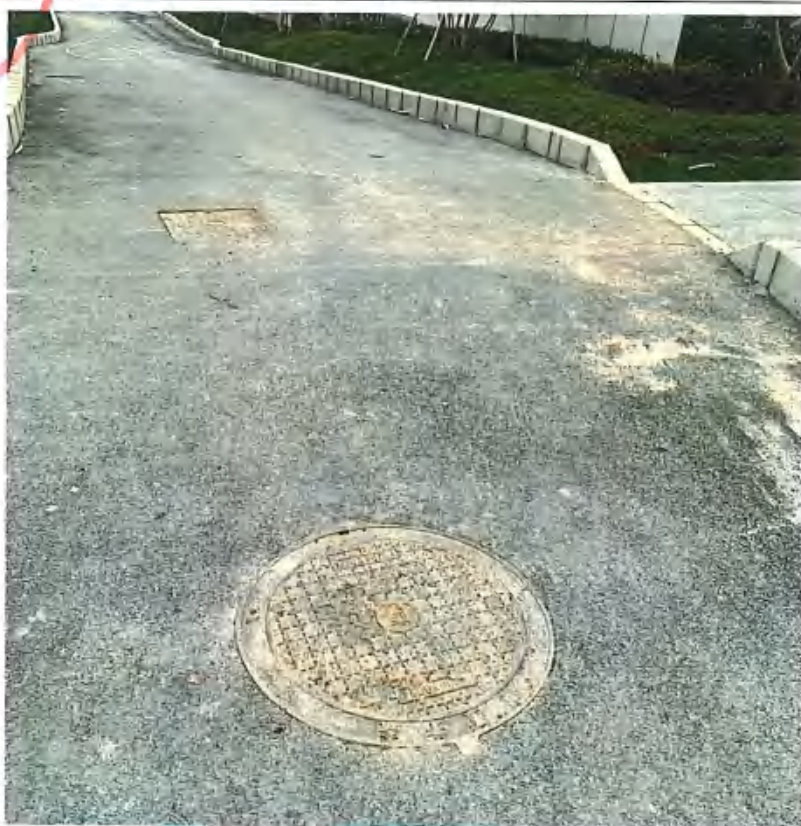
雨水管网-雨水检查井
