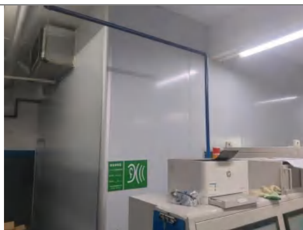
噪声排放源标志牌 ZS-225068（远照） （本项目）
