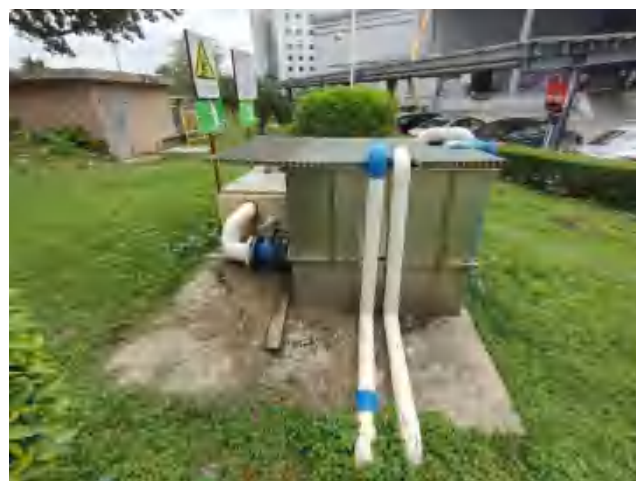
生活废水排放口标志牌 DW0004 (远照) (依托原项目)
