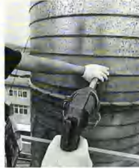
废气排放口 DA006
